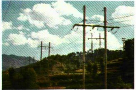
▲ 35KV 输电线路 (赵东 摄)
