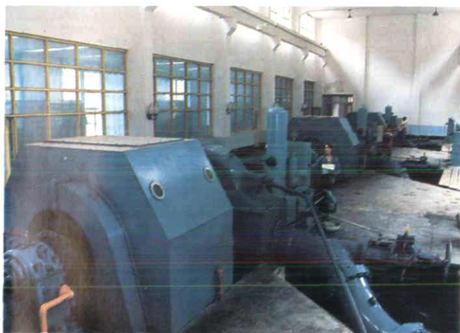
▼ 装机为 3 \times 2500 千瓦的特克电站机房
