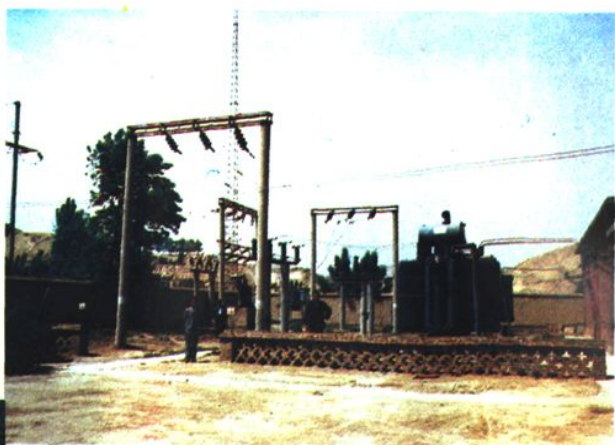
△ 和电方家泉变电所
