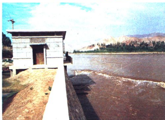
△ 青电西堡一泵站
