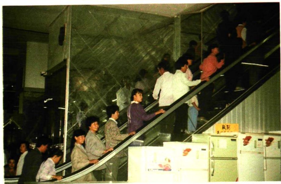
人民商场电动滚梯
