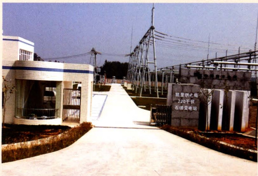
一碗水220kV石坡变电站
