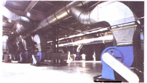
▲打磨、擦净间的排风系统
