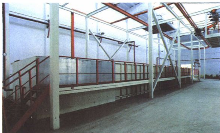
◀ 前处理磷化浸槽
