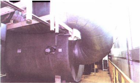
▲炉内废气焚烧装置
