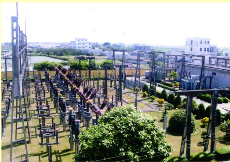
► 110千伏鹤巢变电站
