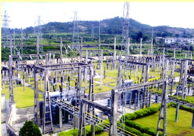
► 110千伏黄冈变电站
