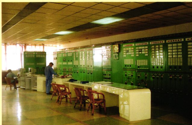
► 220 千伏潮州变电站中控室 (1991 年 11 月 25 日建成)
