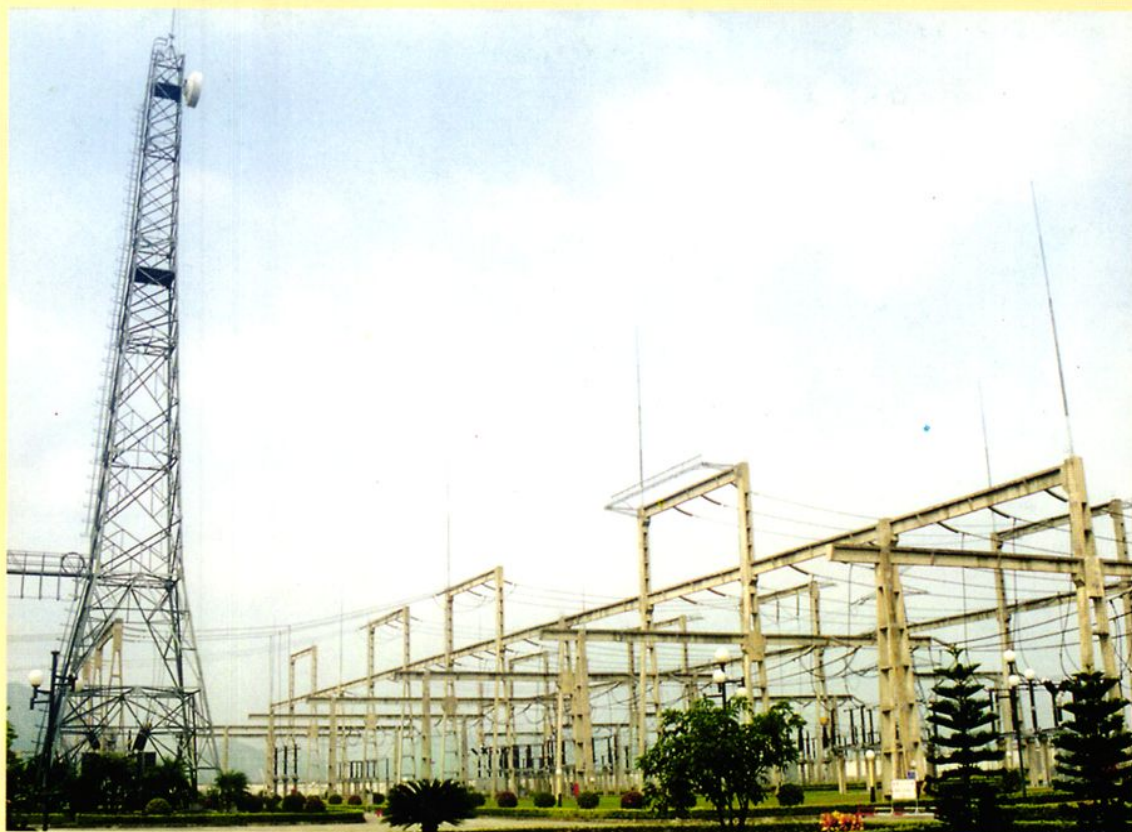
▲220 千伏潮州变电站微波通信塔
