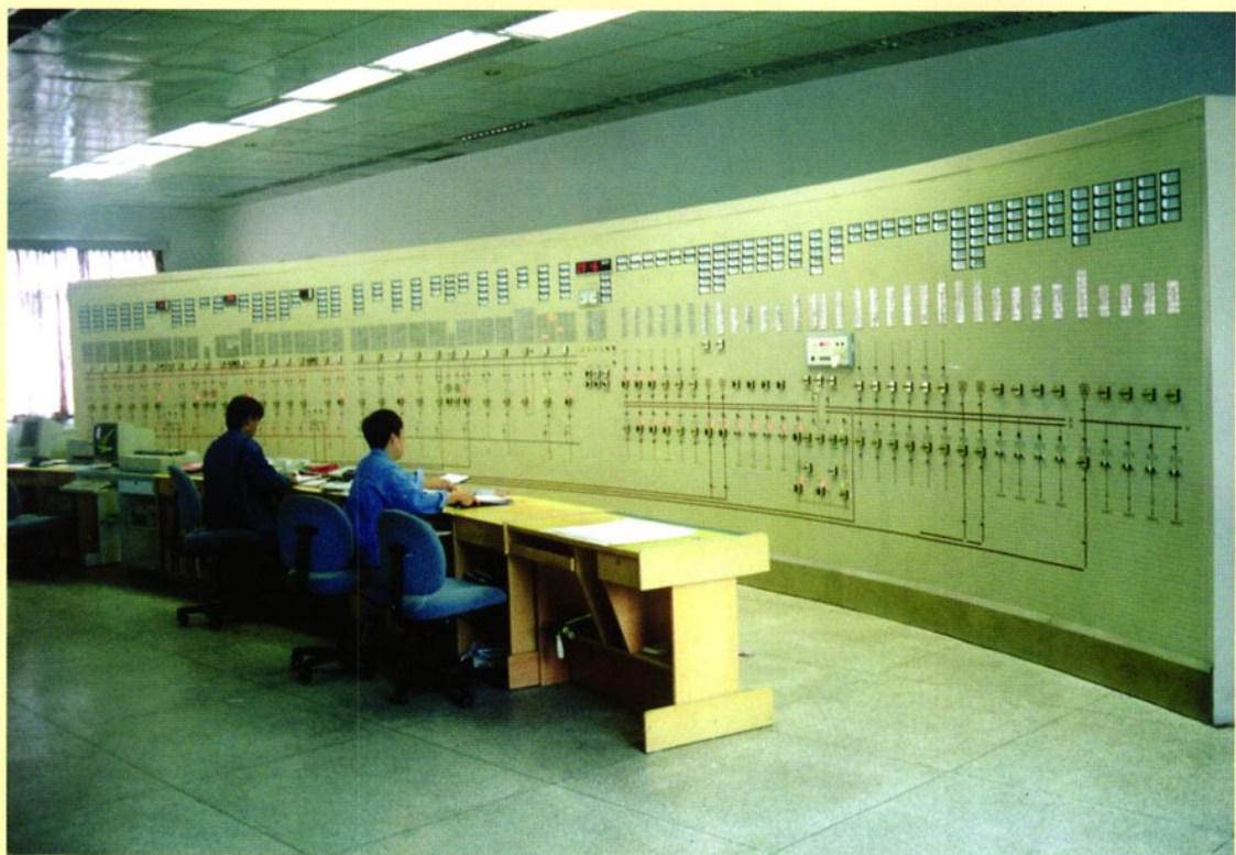
▲220 千伏金砂变电站中控室（1997 年 12 月 28 日建成）
