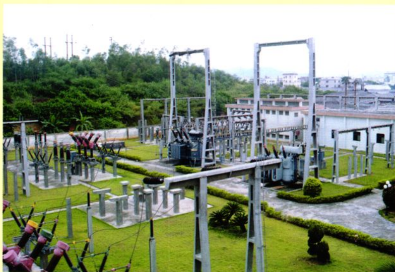
▶ 110 千伏文里变电站
