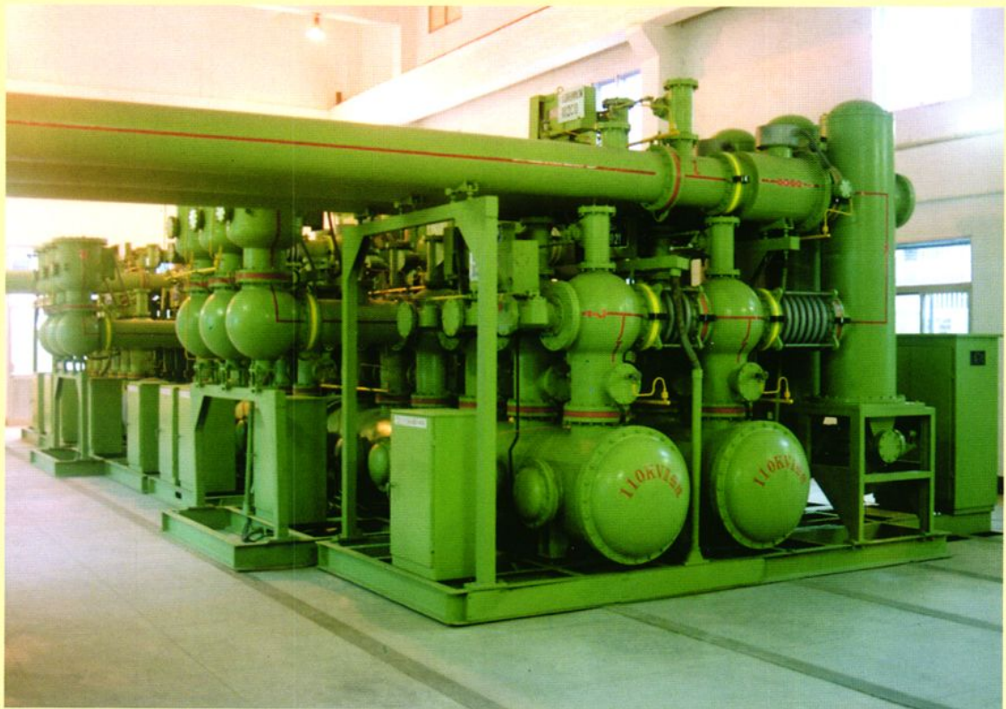
▲110 千伏春光变电站六氟化硫设备
