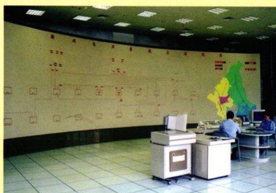
▲潮州电力局调度所
