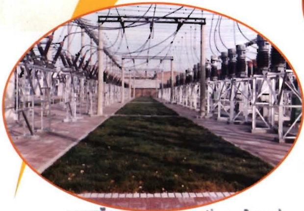
▲ 矿区大隆中心变电所
