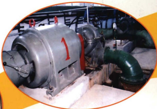
水暖厂供水车间
