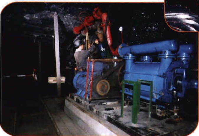
◀ 井下瓦斯抽放泵站
