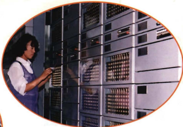
程控交换机房
