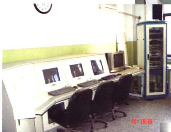
校园网总控室
