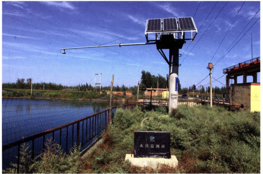
北排河献县护持寺水位监测站
