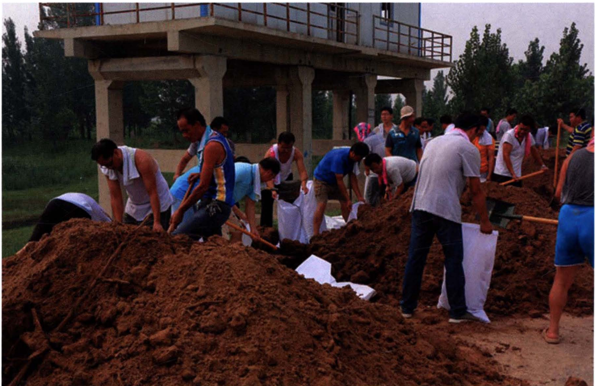
2016年7月27日，献县防汛抗旱指挥部组织民工抢装土袋加高培厚溲沱河行洪道左右两条堤埝
