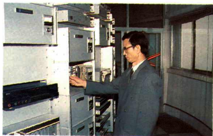
自贡622微波站是川南微波干线的枢纽站, 图为站长刘和生在机房检查8千兆赫哈里斯微波设备的工作情况。
