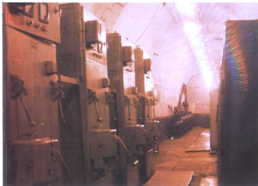
井 下 中 央 变 电 所
