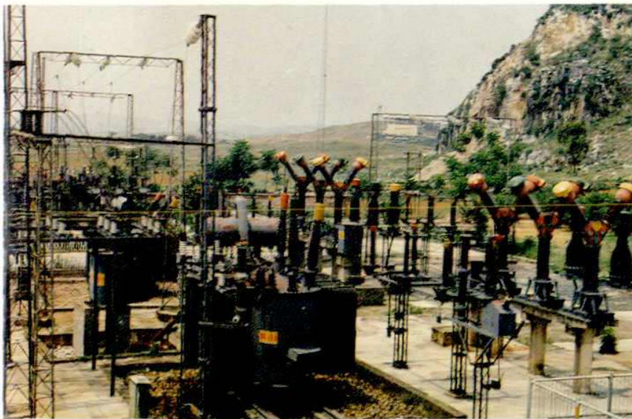
那全变电站(二〇千伏)。
