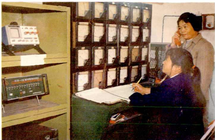
中央变电所主控室。
