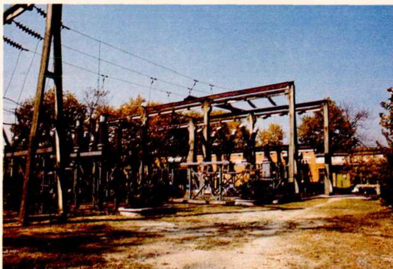
▷ 矿总降压变电所
