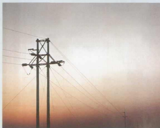
晨曦中的农电 35 千伏线路
