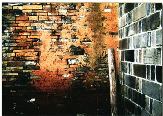
1938年被日机轰炸焚烧后留下的断壁残垣(竹镇中街周楚家)
