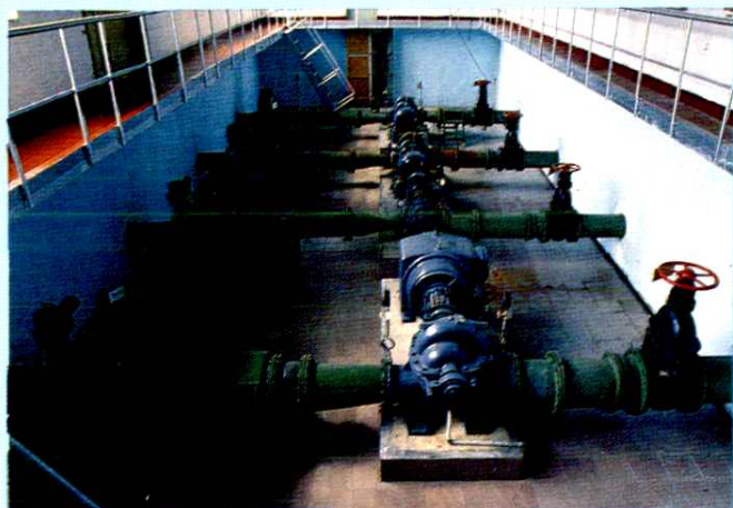
奉化自来水厂机房
