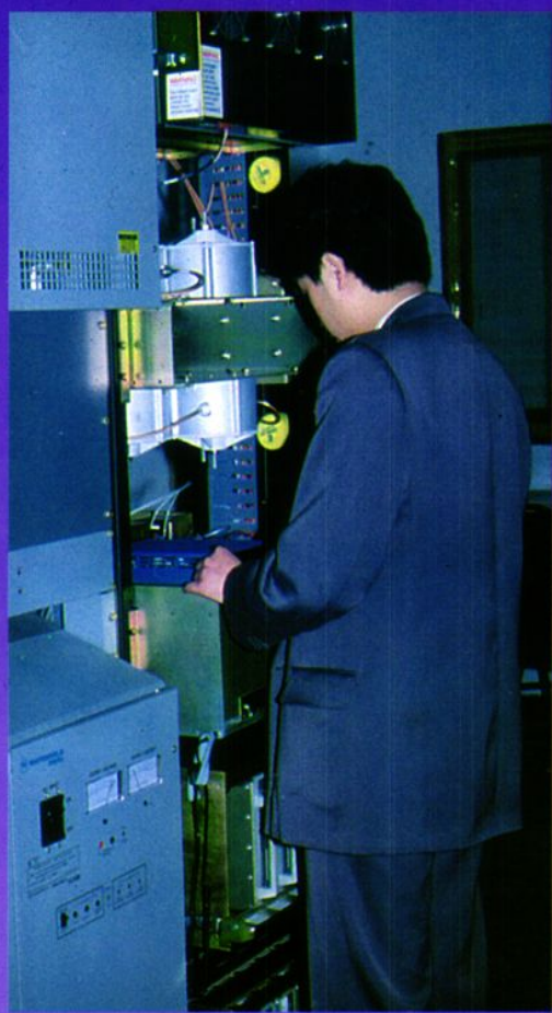
▶ 眉山邮电局移动通信机房
