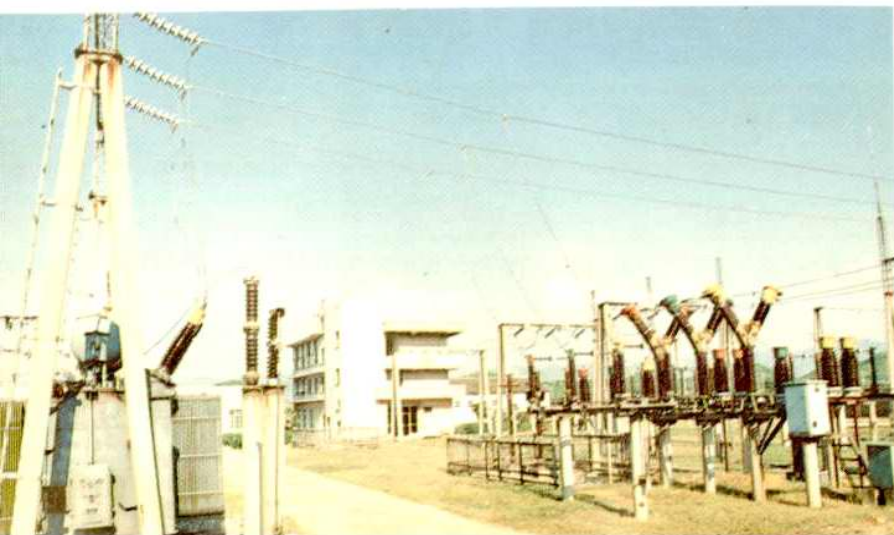
110千伏兴安 县变电站容量2 万 千伏安
