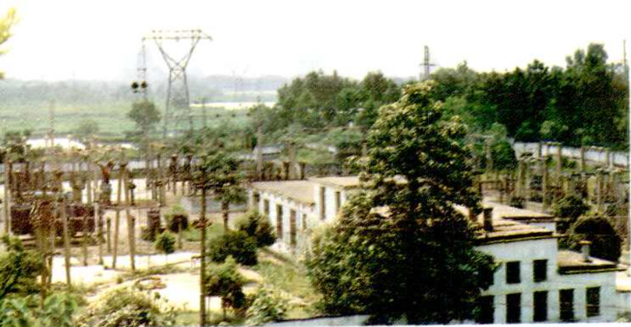
110千伏东 江变电站容量 6.3万千伏安
