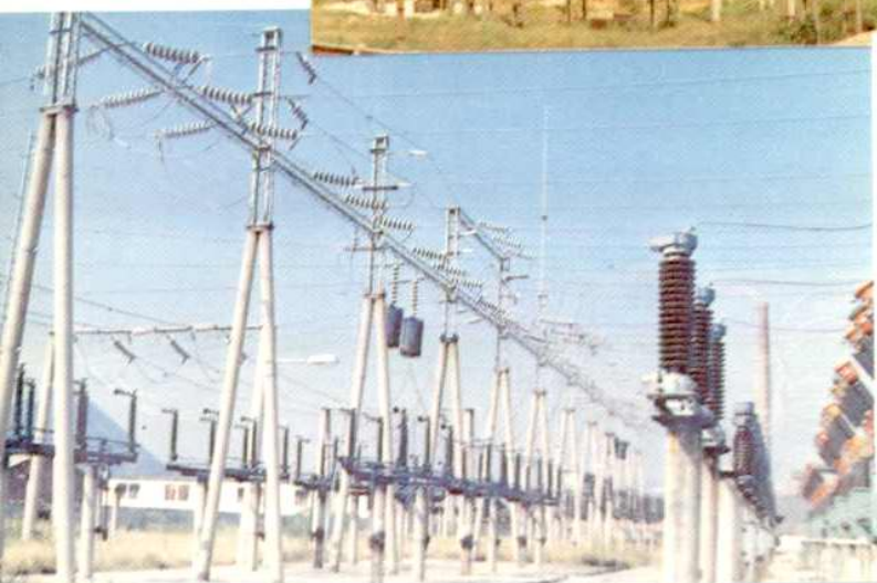
110千伏雉山 变电站容量8万 伏安
