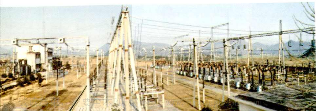
220千伏巖村变电站容量18万千伏安
