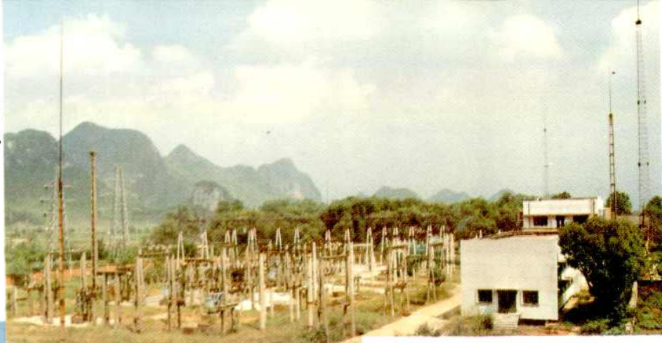
110千伏北门 变电站容量8万 伏安
