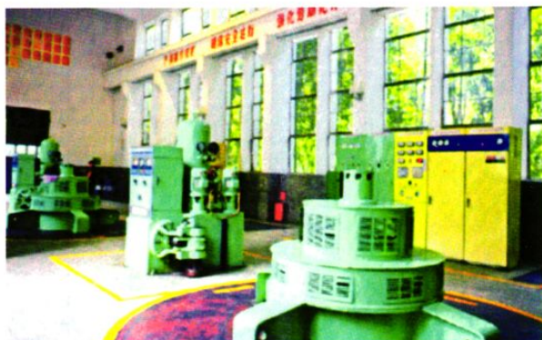
陈家湾电站机房 (2006年摄) (图47)
