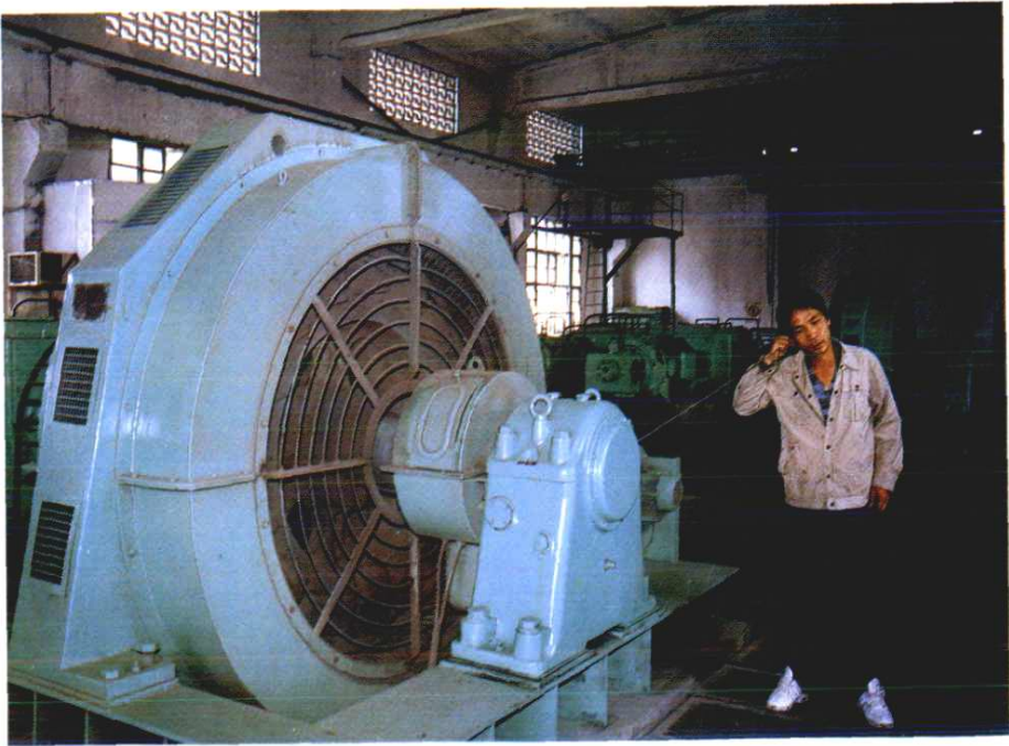
福州耀隆工贸总公司氮肥厂4M8 高压机生产装置
