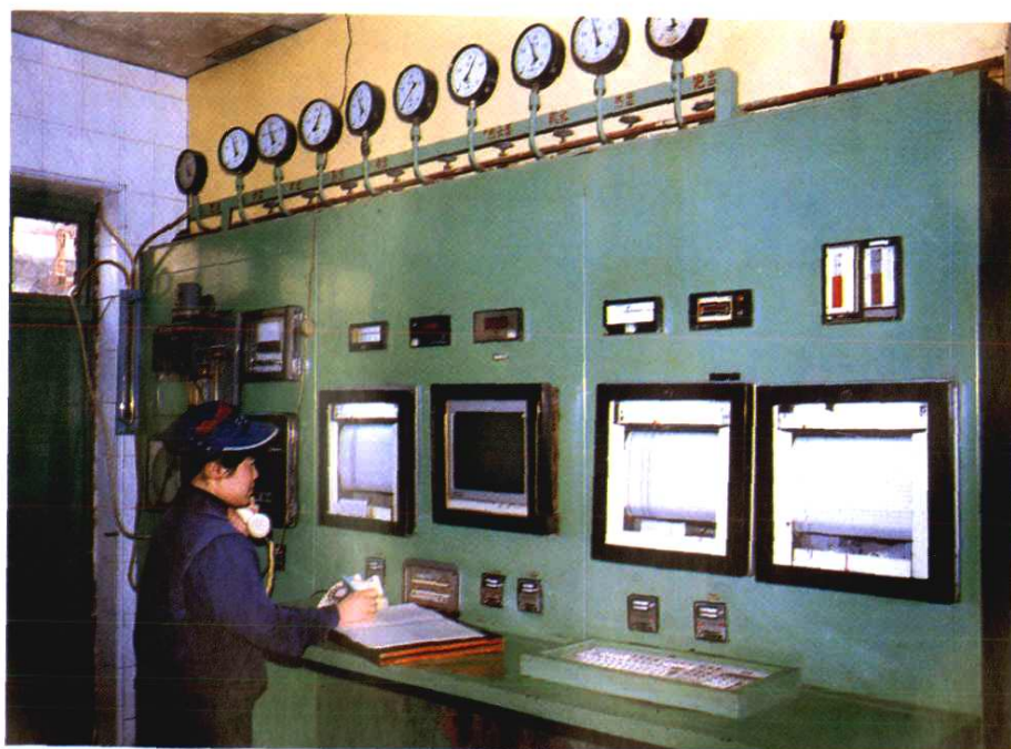
福州耀隆工贸总公司氮肥厂微机控制操作室一角
