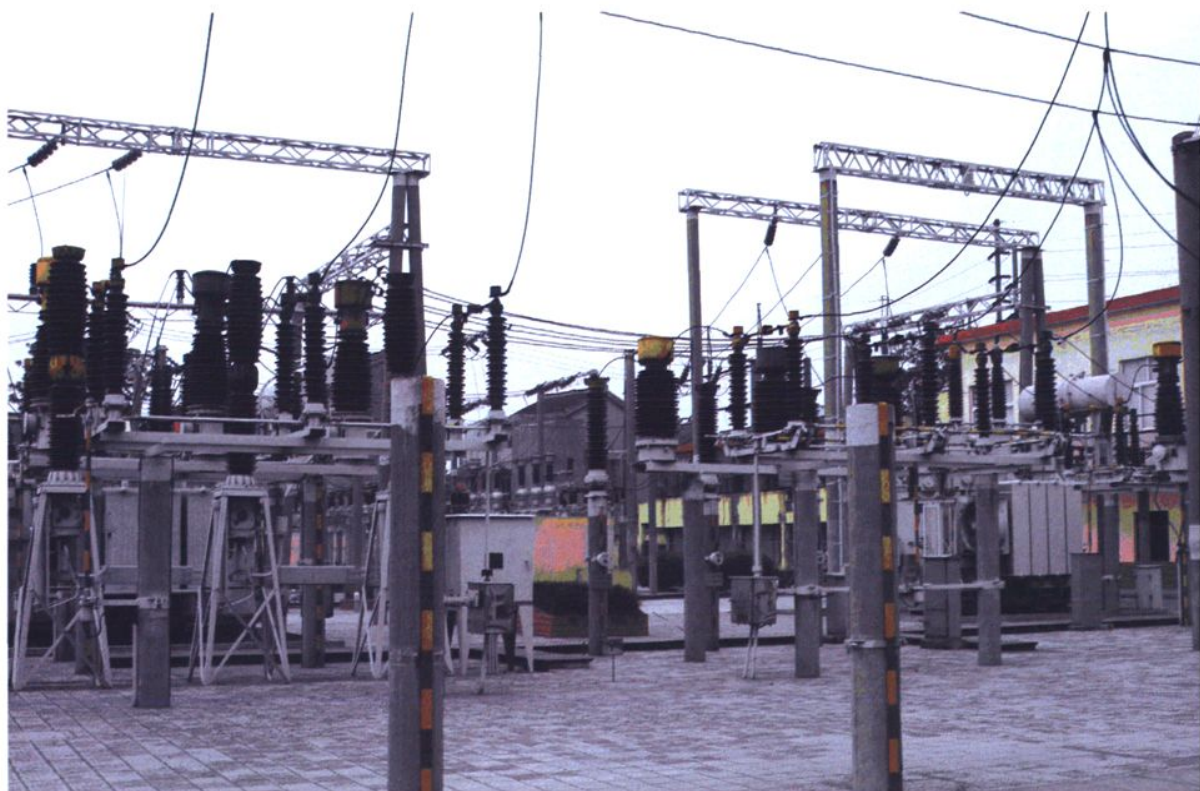
110千伏夏桥变电所(摄于1987年5月3日)
