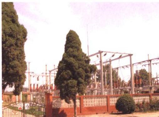
▲ 110千伏翼城变电站
