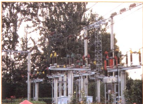
▲ 35千伏城西变电站
