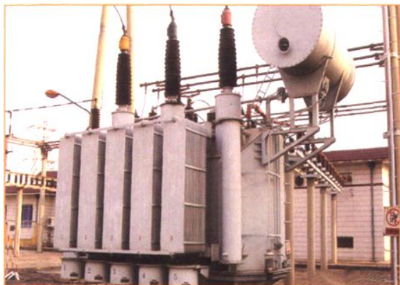
▲ 35千伏里砦变电站
