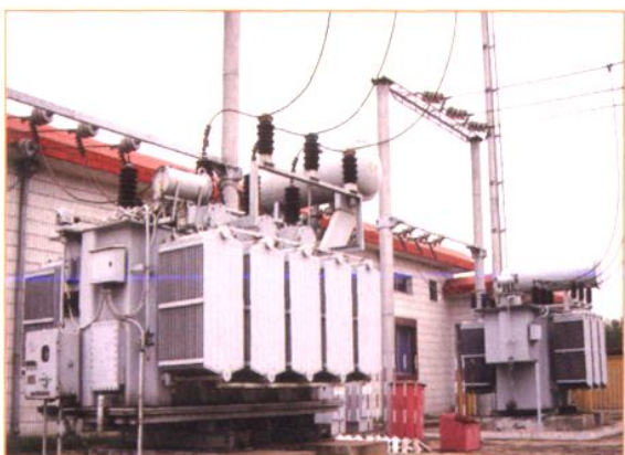
▲ 35千伏王庄变电站
