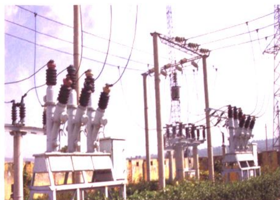
▲ 35千伏南梁变电站
