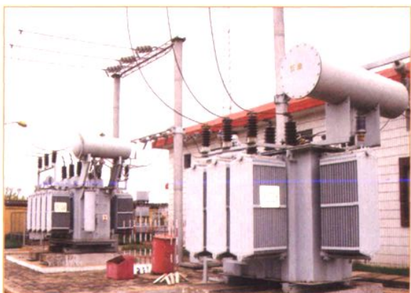
▲ 35千伏辛安变电站
