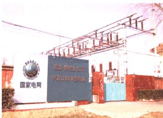
▲ 110千伏中卫变电站
