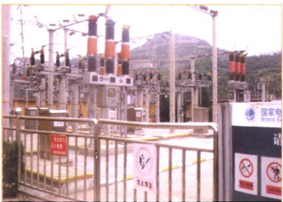
▲ 35千伏桥上变电站
