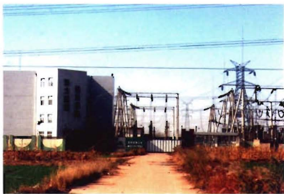
坐落在姚官屯境内220KV变电站
