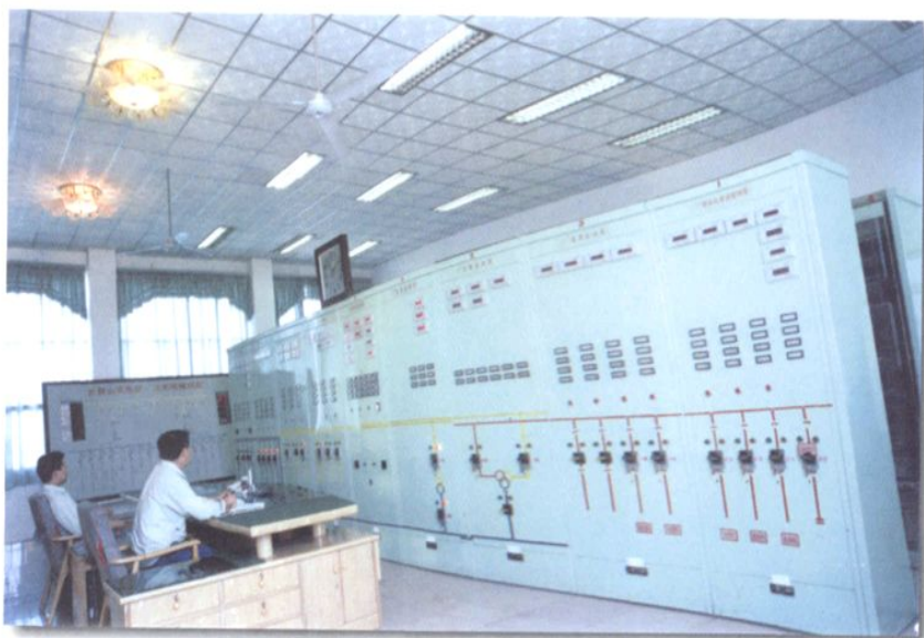
◀ 中峰云煤一矿35KV变电站控制室
