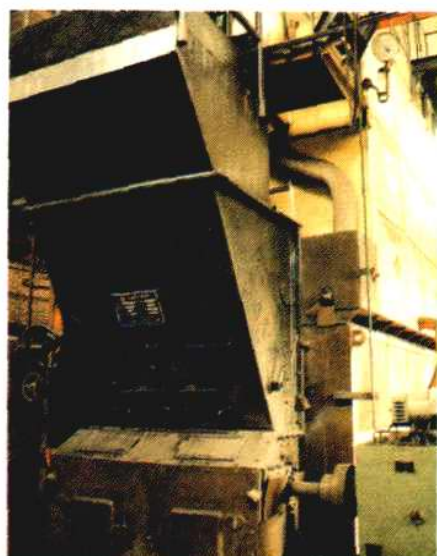
6t/h鍋爐成套工程
