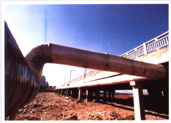
城市集中供热管道
