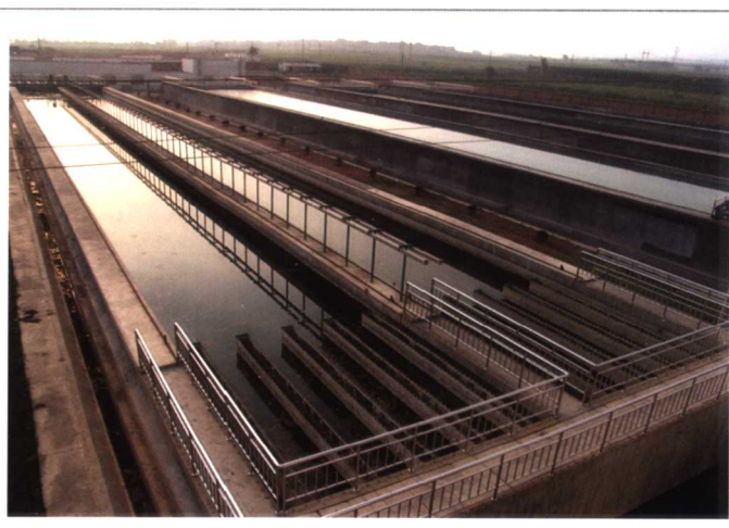
城市供水工程——13万吨水厂
