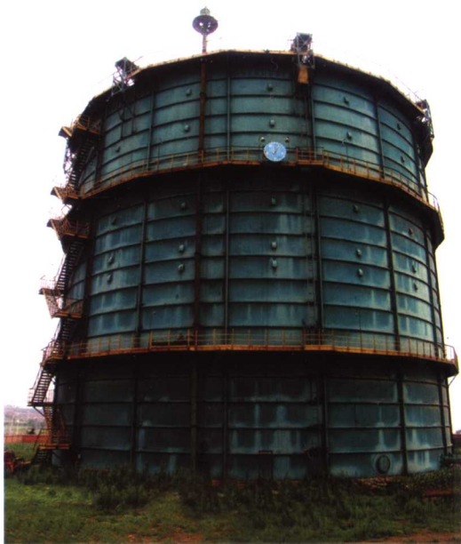
城市民用煤气储气罐
