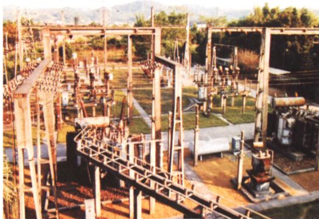
110千伏平远变电站（卓运淦 摄）
