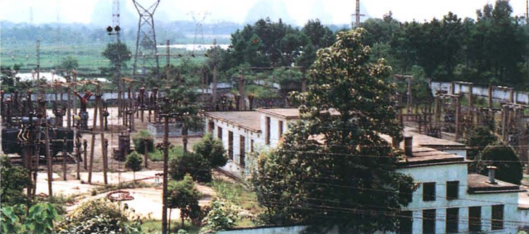
110千伏东 江变电站容量 6.3万千瓦安
