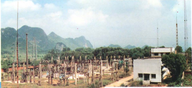
110千伏北门 变电站容量8万千 伏安
