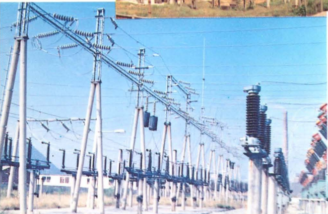
110千伏雉山 变电站容量8万千 伏安
