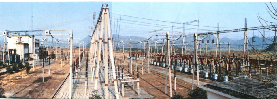
220千伏巖村变电站容量18万千瓦安
