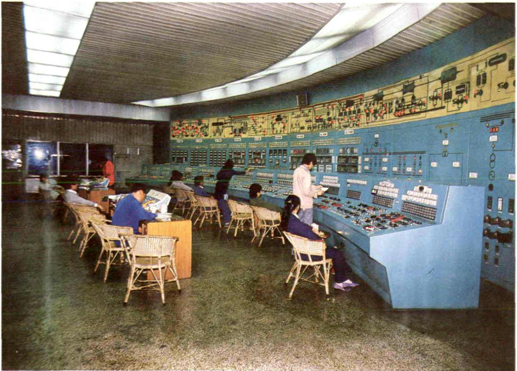
↓ C廠集控室
