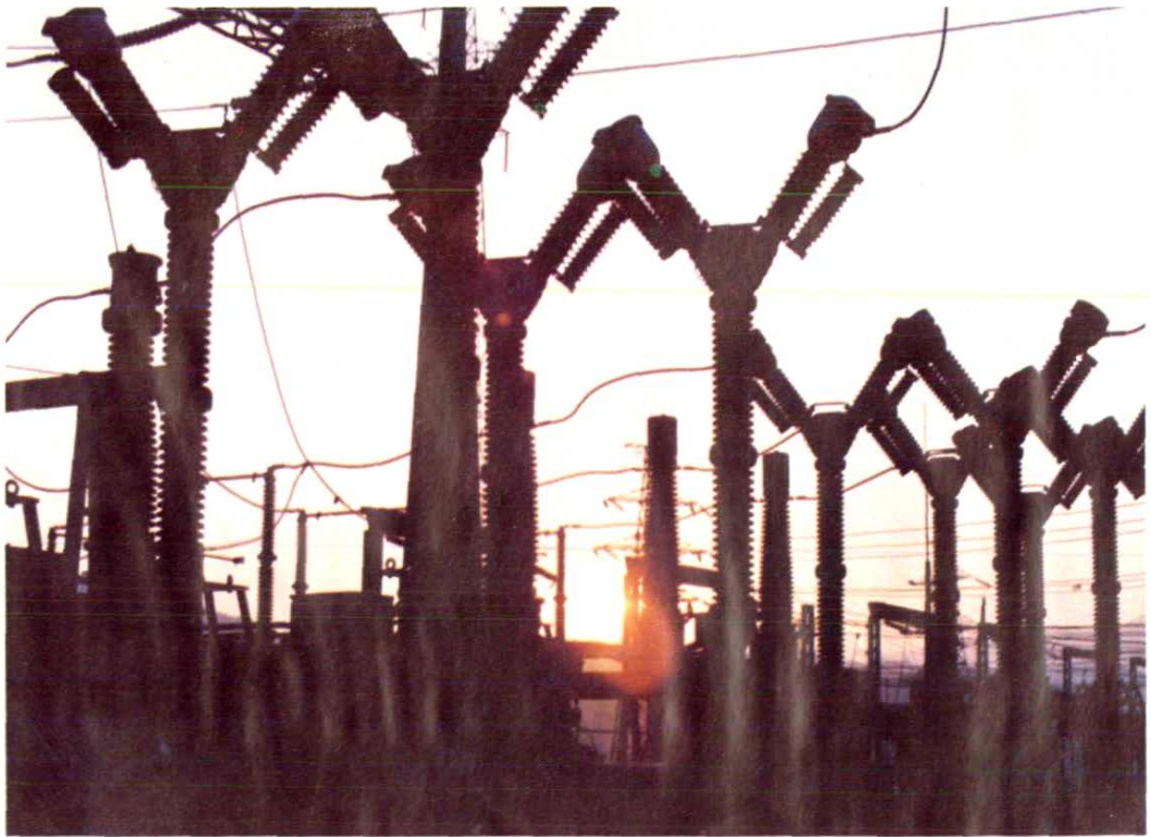
↓ 2萬伏特升壓站一角
