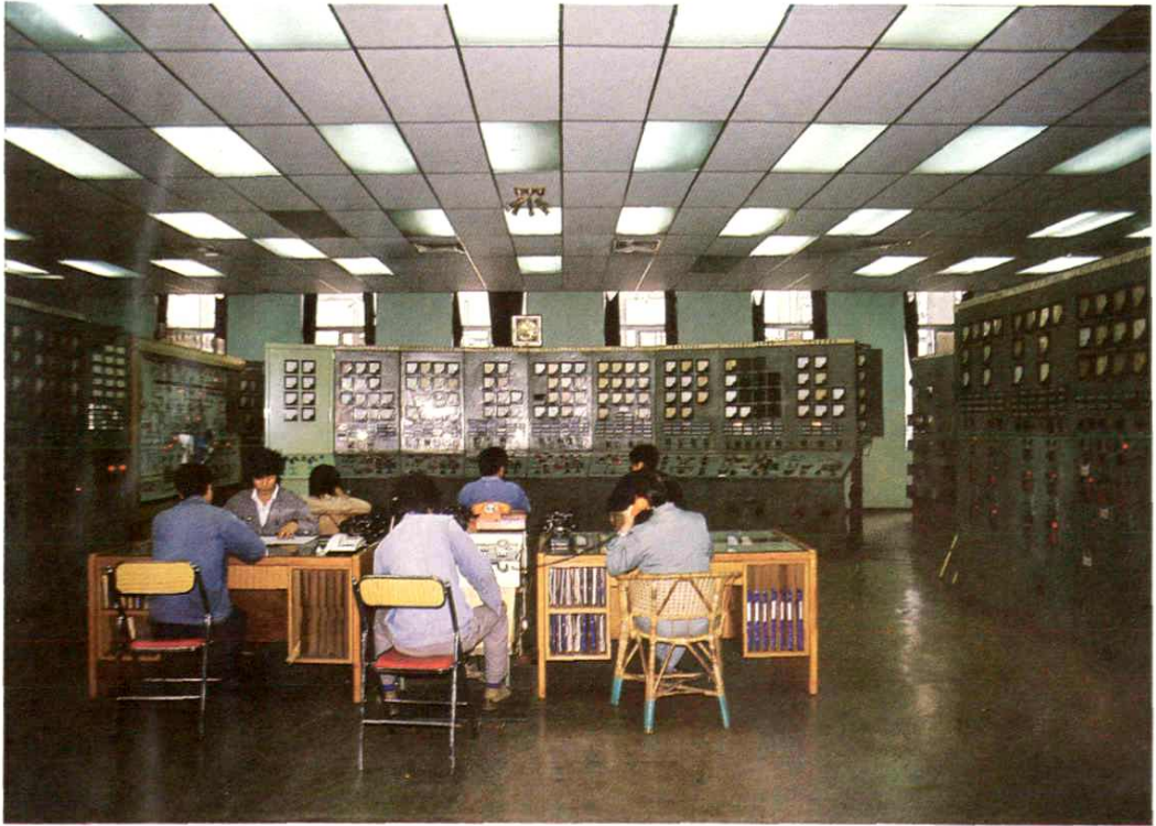
↑ A B廠電氣主控室
