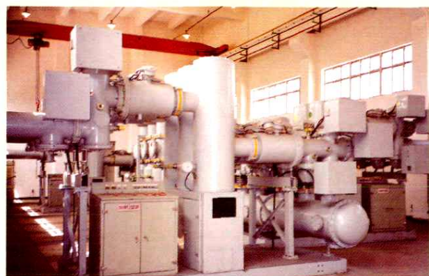
110千伏变电所六氟化硫设备
