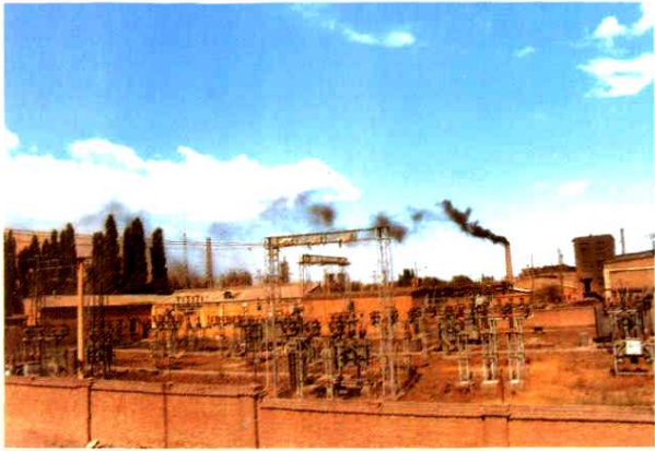
35 千伏钢南变电所
