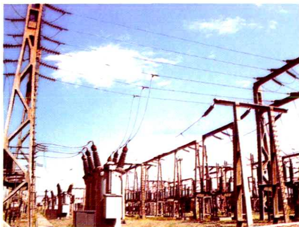
1964年建成的新疆第一座110千伏变电所—— 三宫变电所
