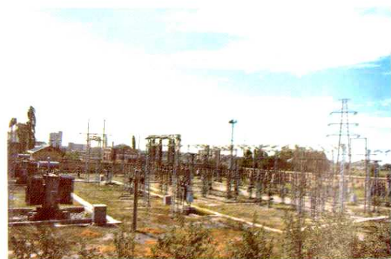
八十年代六道湾变电所设备区
