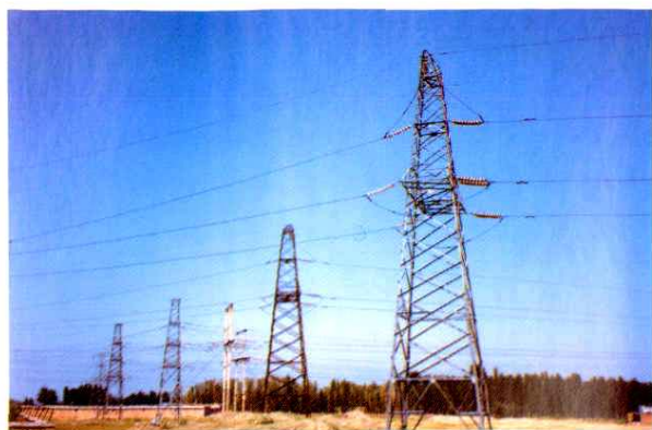
220 千伏米泉变电所出线铁塔
