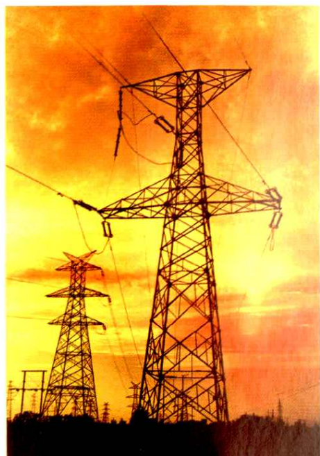
220 千伏头屯河变电所出线铁塔群
