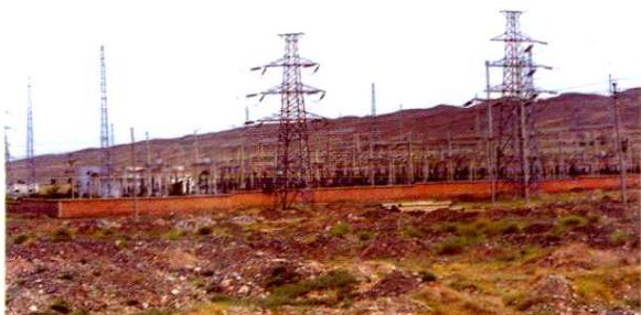
220千伏头屯河变电所外景
