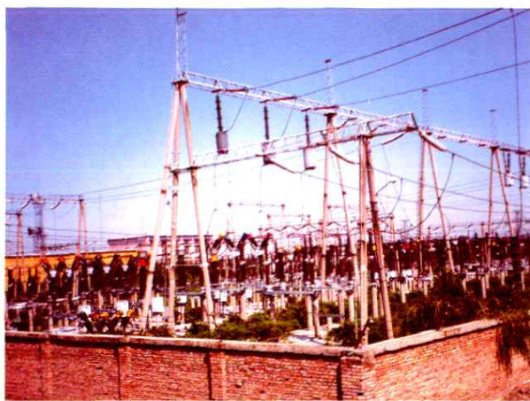
1986年建成的新疆第一座220千伏变电所—— 米泉变电所
