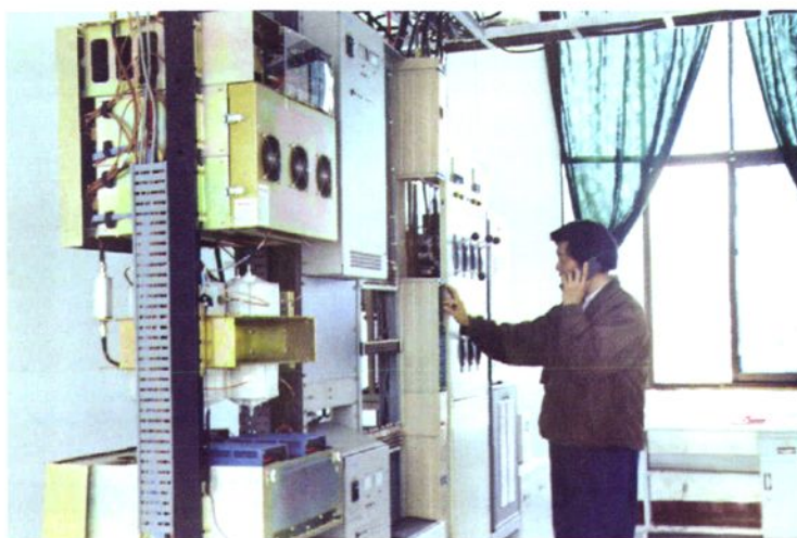
900MHz 移动电话机房
