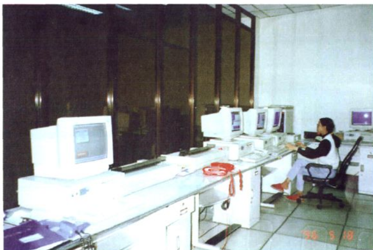
县局程控机房
