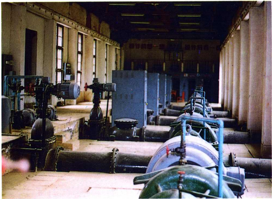
渭高干段家湾抽水站的机泵
