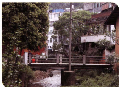
上街暗桥(相安居委会)。清代建造。仅保存桥墩。桥面原为木结构，有廊覆以瓦。现改为钢筋混凝土供人车通行。摄于2016. 4. 28
