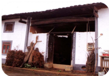
林振波故居(长南鹤窠)，1931年，万赣南游击大队队部所在地。清代建造，土木结构瓦房。2014年新农村建设时外墙进行过粉刷。摄于2016.4.17
