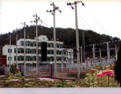
横市镇35KV输变电站
