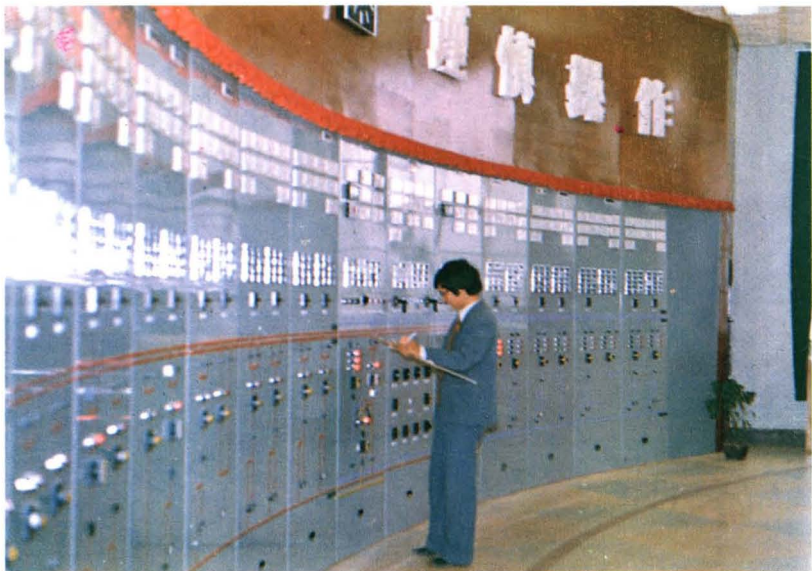
220千伏朱村变电所控制室
