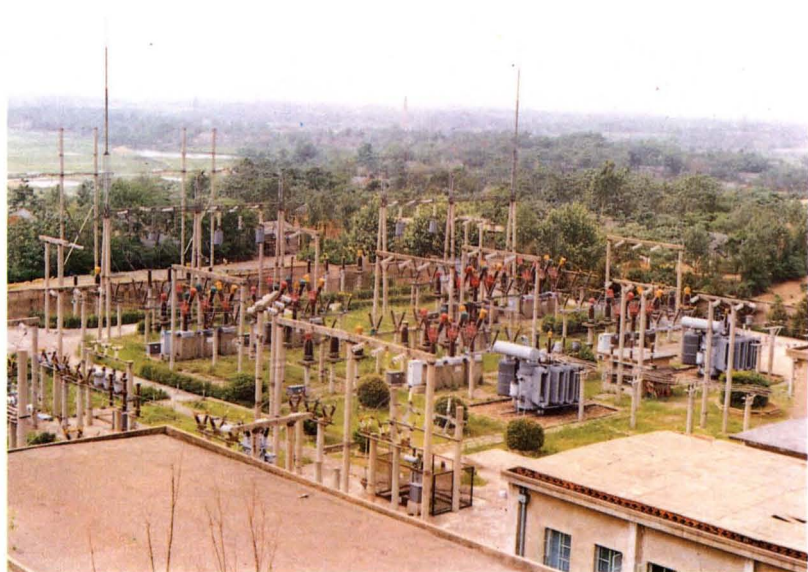
110千伏新桥变电所鸟瞰
