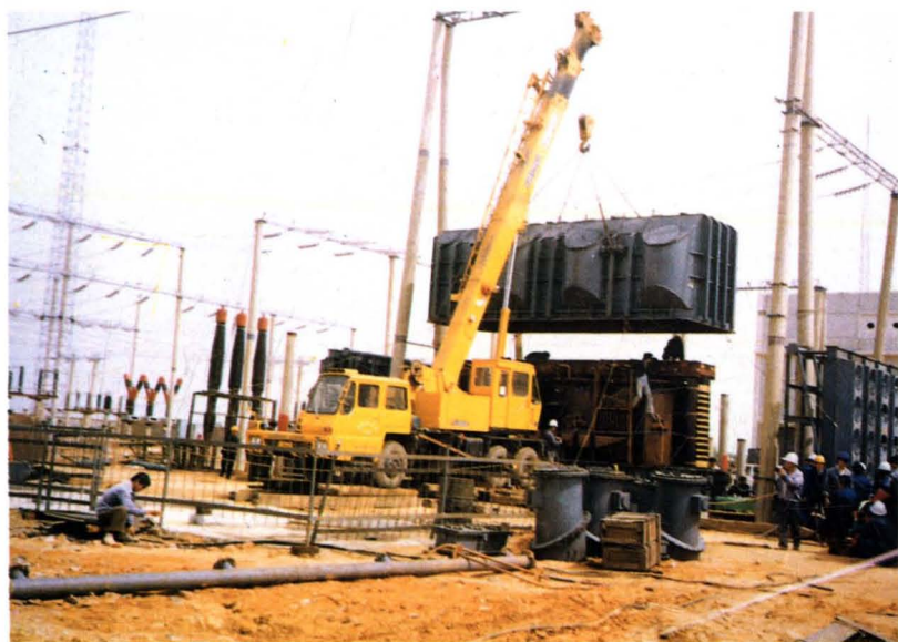
220千伏朱村变电所120000千伏安变压器在投入运行前吊罩作详细检查
