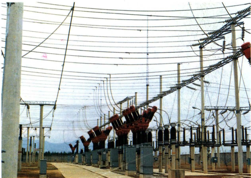
220千伏朱村变电所室外配电装置
