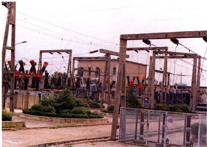
110千伏谢家垅变电所
