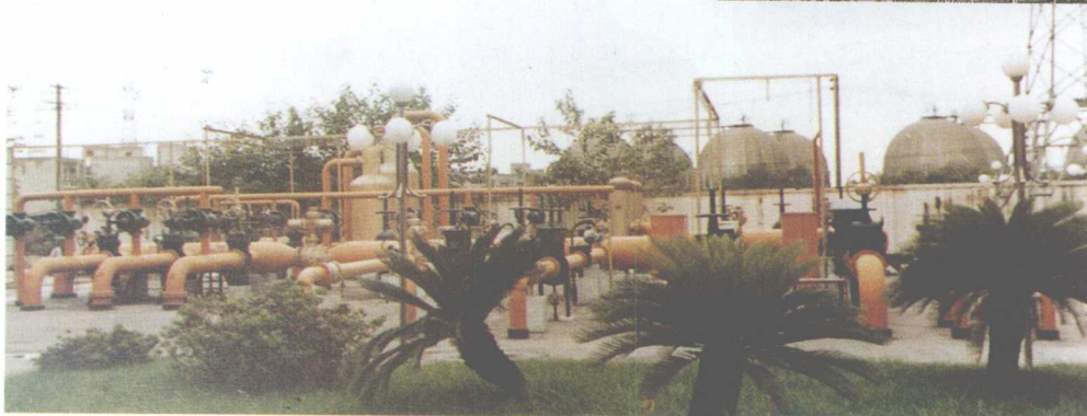
成都市第一配气站
