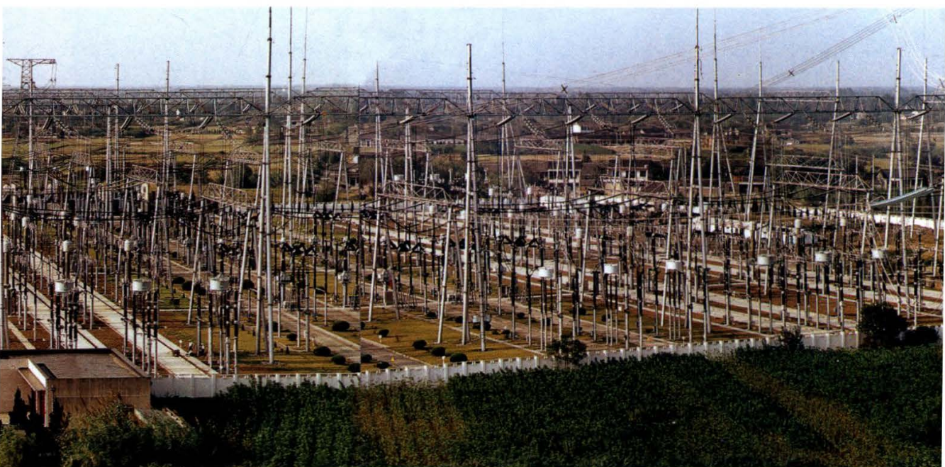
1988年，500千伏扬州江都变电所
