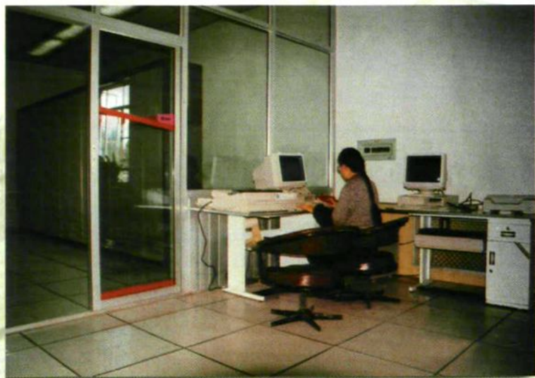
程控电话交换机房
