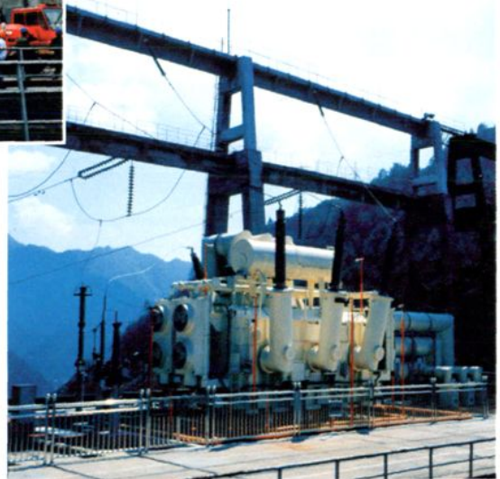
2001年9月29日投产的01号主变压器
