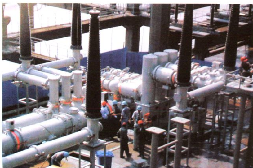
2005年安装2387线路GIS断路器
