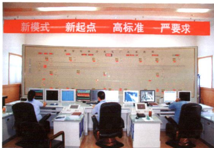
2003年3月投入使用的新中央控制室
