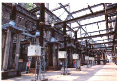
220千伏线路断路器
