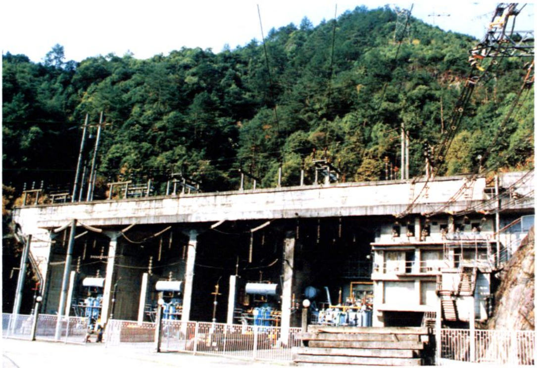
1999年前的2号主变压器掩体
