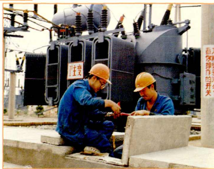
110 千伏秀水变电站
