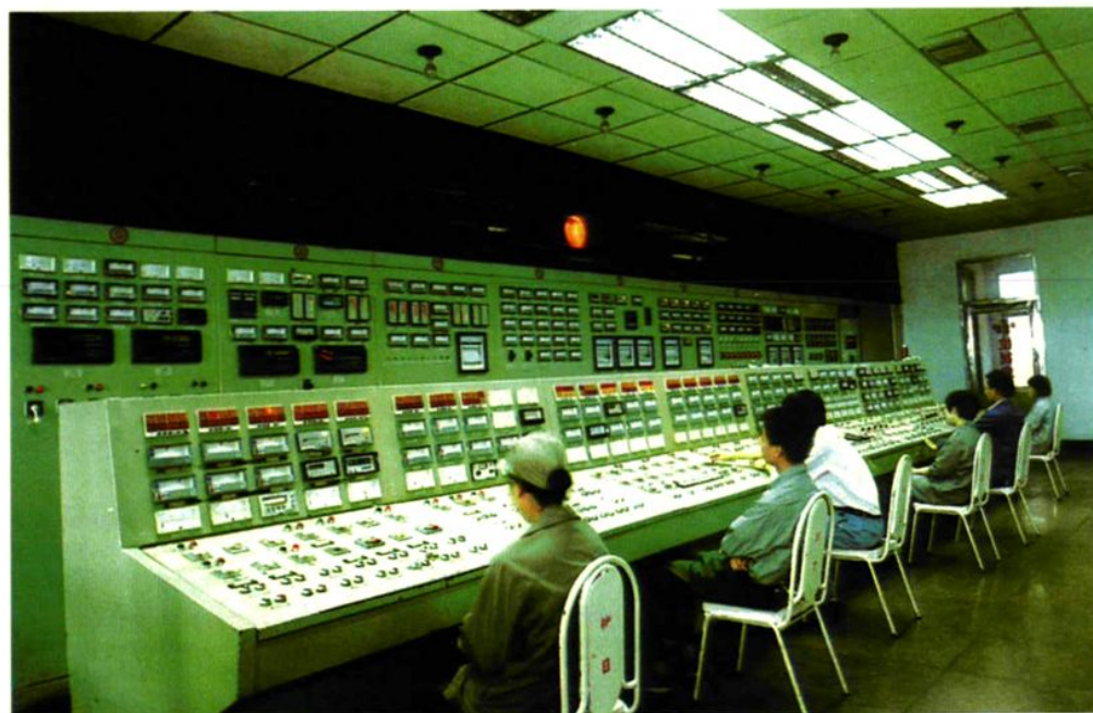
电力工业是经济发展的动力,市建行积极支持合肥地区的电力建设,图为市建行贷款支持的合肥电厂控制室。
