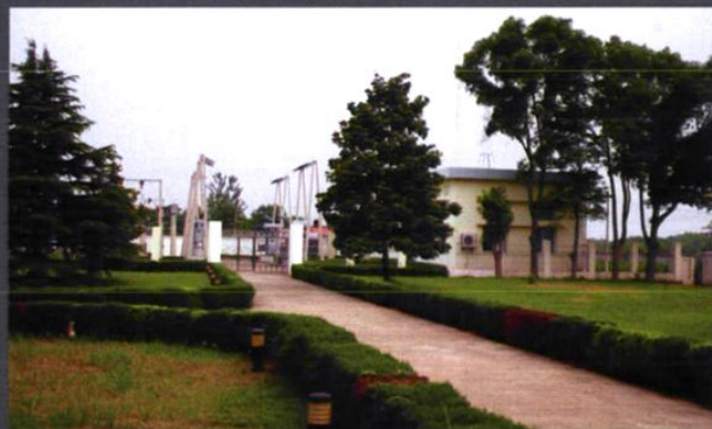
2002年，就地改造的35千伏罗店变电站
