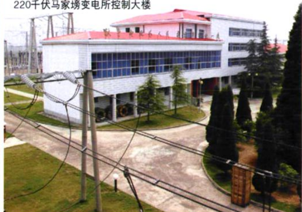
220千伏马家垆变电所控制大楼
