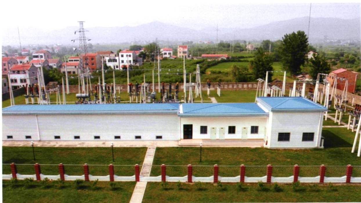
2003年，改造后的京山变电站
