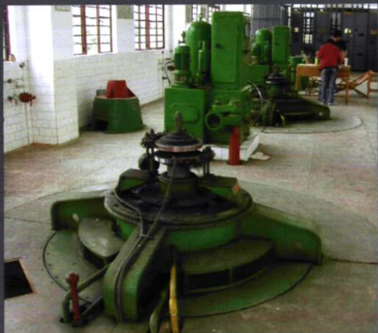
高关水电站发电车间
