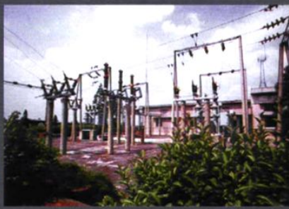
1983年8月，35千伏杨集变电站建成投运
