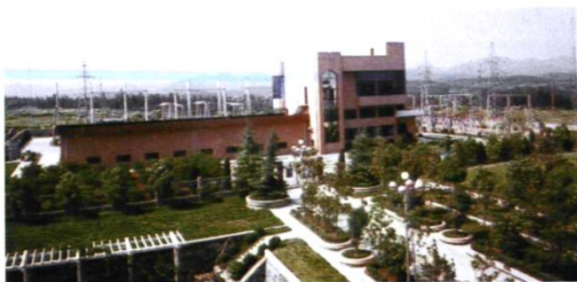
1979年5月，35千伏宋河变电站建成投运，1992年就地升压改造，1998年8月，110千伏宋河变电站建成投运
