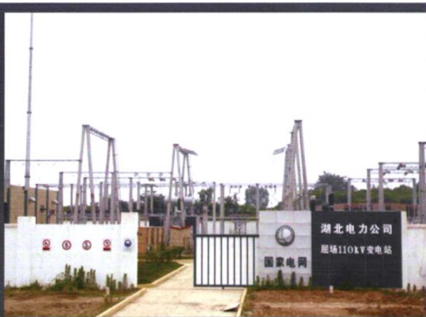
2008年9月8日，110千伏屈场变电站建成投运
