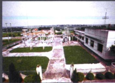
1980年5月，35千伏永兴变电站建成投运， 1985年12月搬迁重建的永兴变电站
