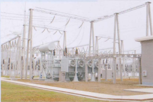
■ 220千伏悬鼓洲变电站
