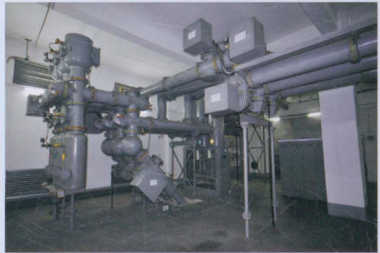
■ 十堰城区第一座地下110千伏中心变电站
