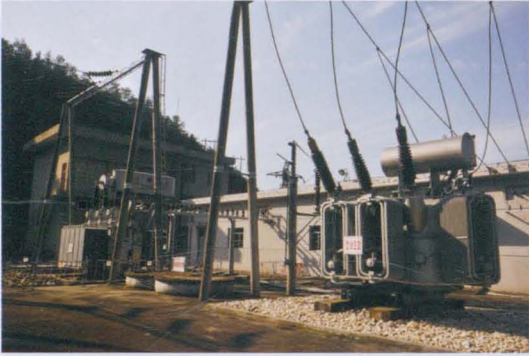
■ 20世纪70年代初投运的110千伏岱湾变电站
