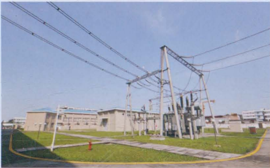
■ 220千伏均州变电站
