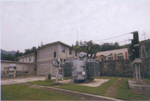
■ 20世纪70年代投运的110千伏枣园变电站
