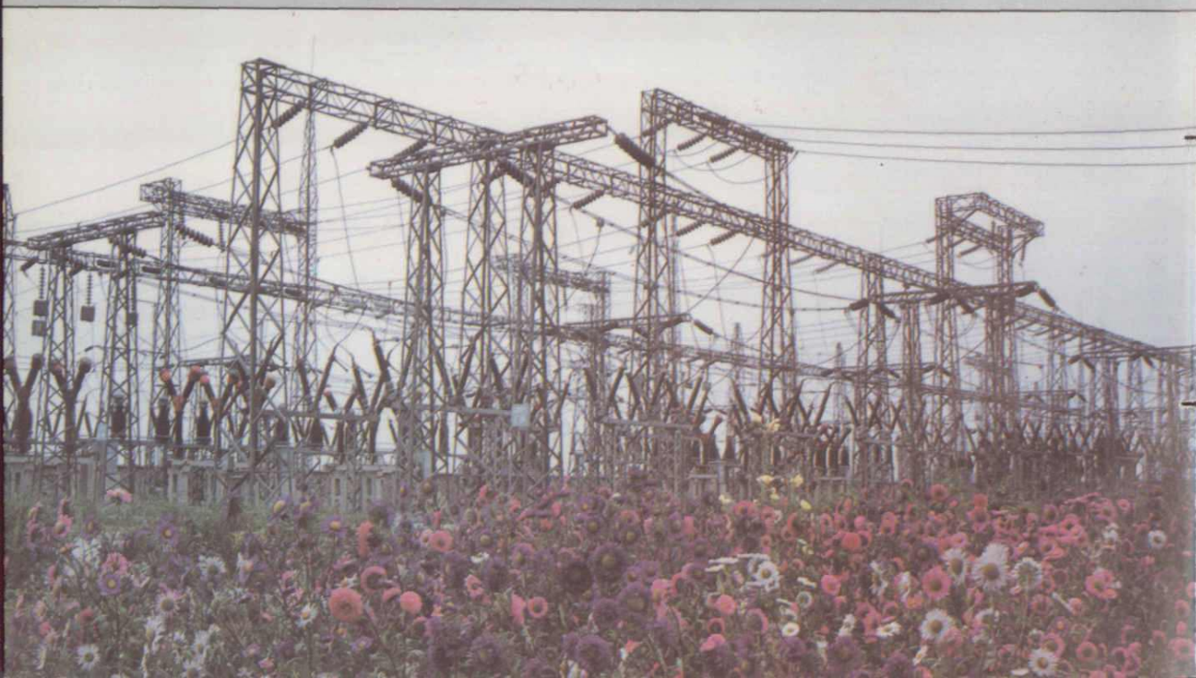
包头麻池 220 千伏变电站
