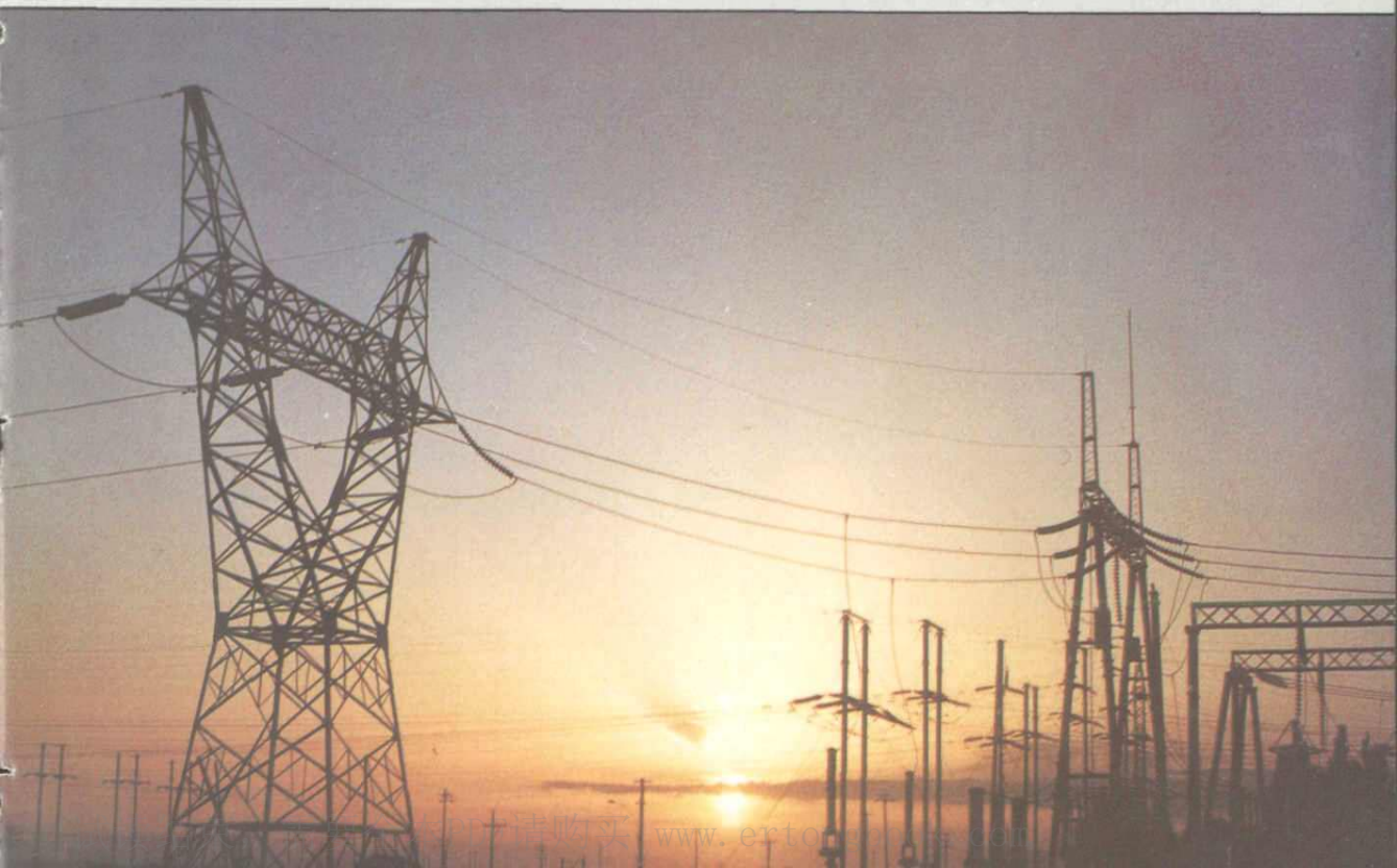
乌包 220 千伏输电线路出线塔及乌拉山电厂升压站
