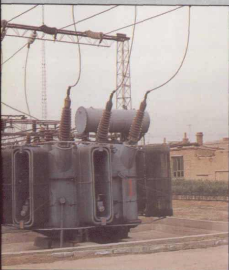
包头东河 110 千伏变电站
