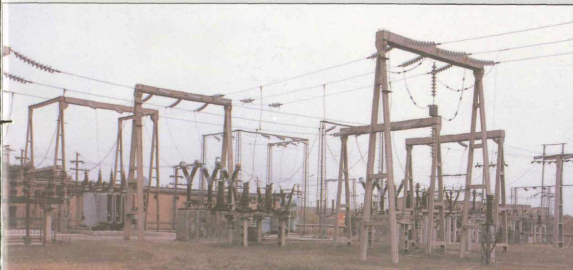
白云鄂博 110 千伏变电站
