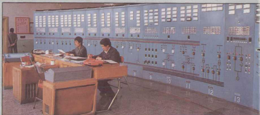
呼和浩特东郊 220 千伏变电站
