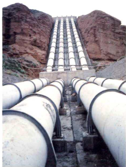
景泰川电灌工程上水管道
