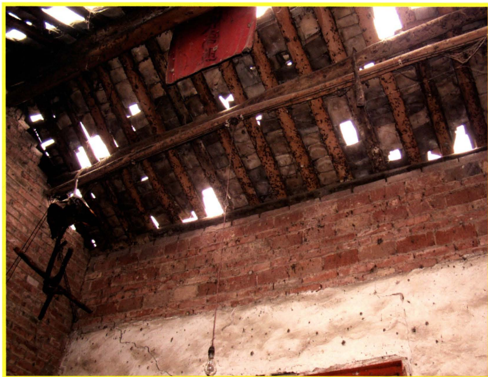
“5·12”地震造成梧风乡一农户的房顶瓦片滑落
