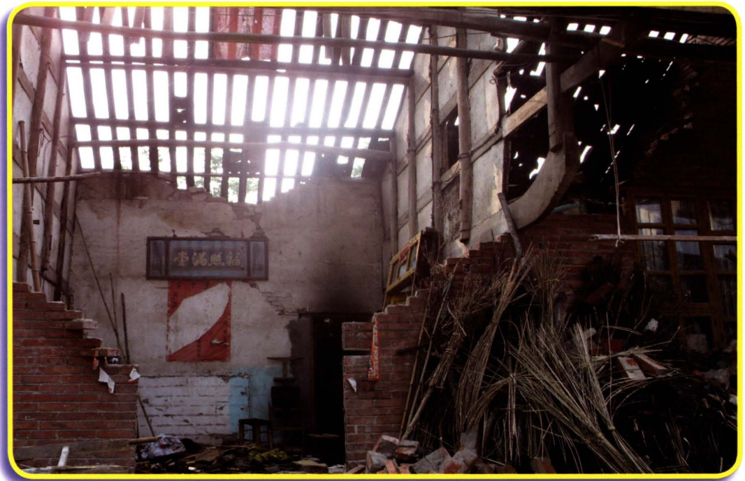
“5·12”地震造成迎江乡一农户的房屋严重损毁
