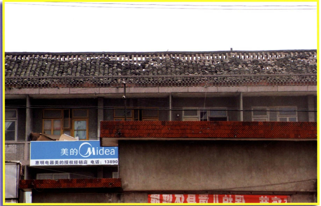
“5·12”地震造成麻柳乡一农户的房顶瓦片滑落
