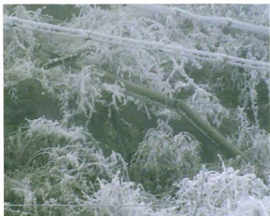
雪凝损毁的电杆
