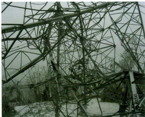
雪凝损毁的输电铁塔
