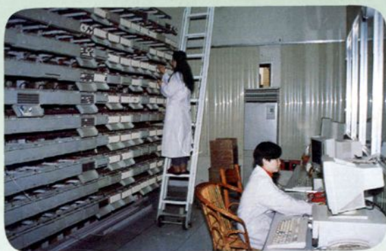
程控电话交换机房 112 测试台和配线架
