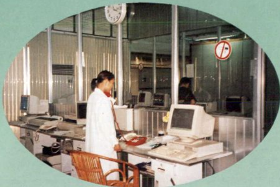
程控电话交换机房操作室
