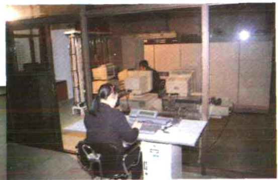
程控电话机房
