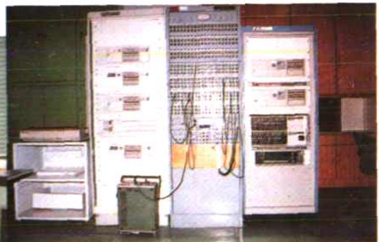
电网调度自动化系统
