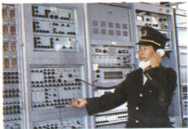
县载波机房一角
